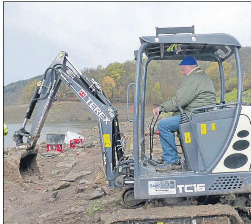
Mini-Bagger: Karl-Heinz Emde, Ausbildungsmeister des Lehrbauhofs, nutzte die moderne Technik, um Schlamm aus dem alten Gemäuer zu entfernen.
